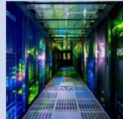
Green Datahub (Rechenzentren)
